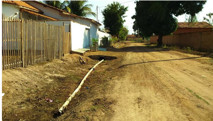
Figura 28. Lançamento de esgoto a céu aberto. Foto: Flavio A. Crispim (2017).
