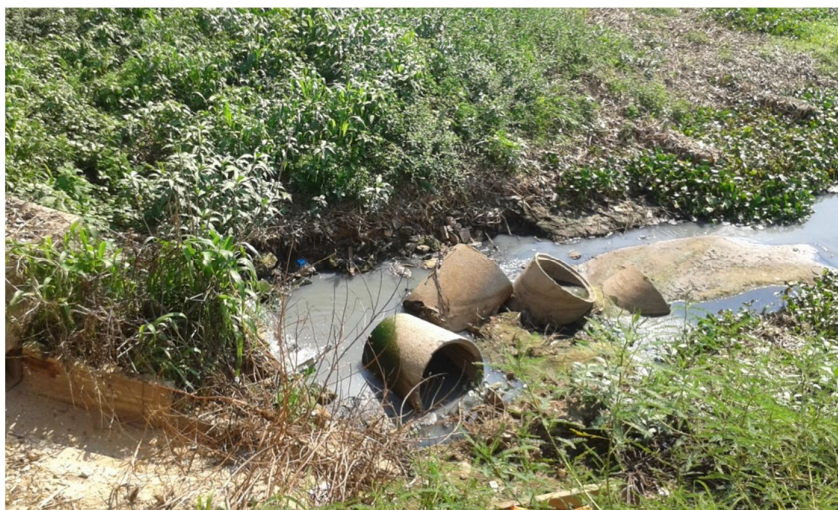
Figura 55: Tubulação de esgoto danificada, Cáceres-MT. Fonte: Acervo pessoal, 2017.
