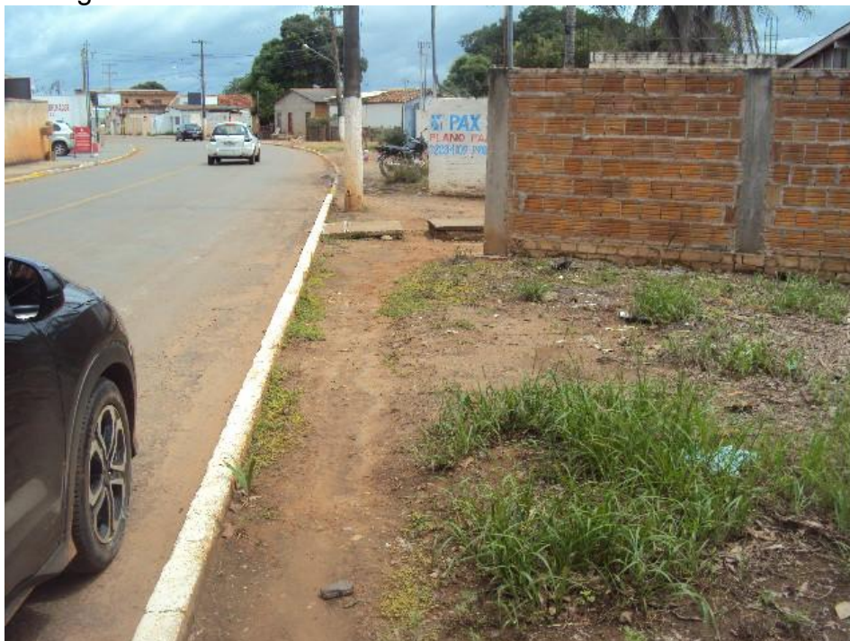
Figura 5.10 – Exemplo de inexistência de calçada ou em manutenção: avenida Getúlio Vargas.
